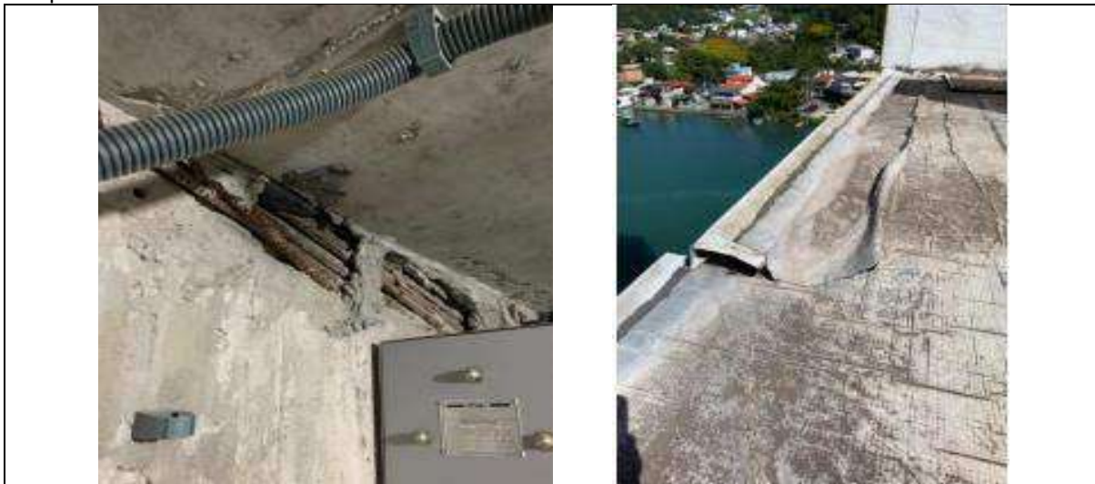
Figura 11 – Risco 12: Armadura exposta na casa de máquina. Impermeabilização de laje comprometida
