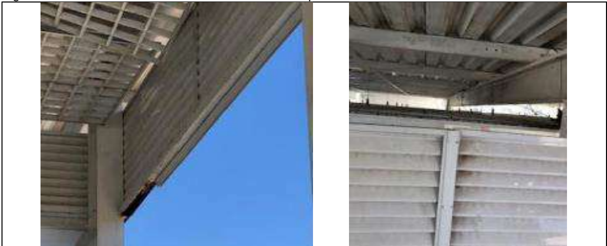
Figura 10 – Risco 11: Corrosão em estruturas de suporte da veneziana. Veneziana mal fixada.
