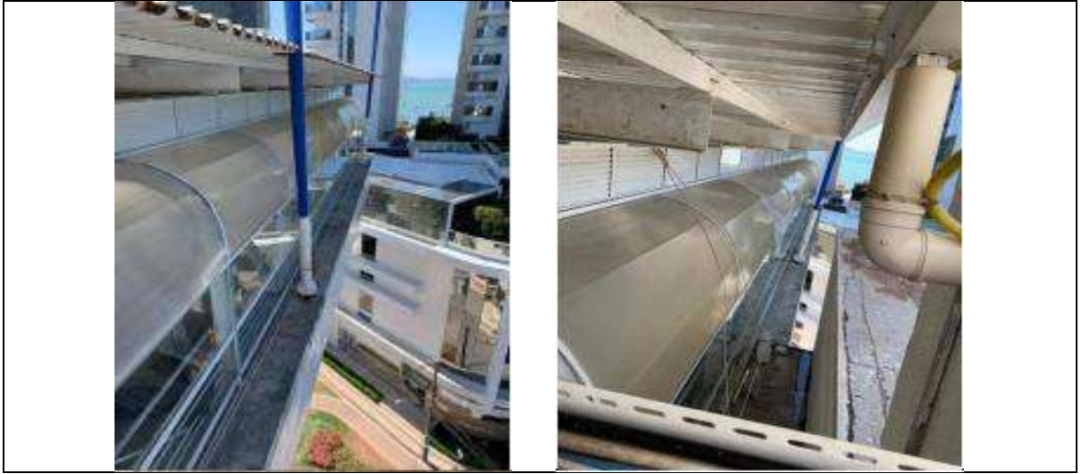
Figura 4 – Risco 03: Chapas acrílicas com risco de queda.
