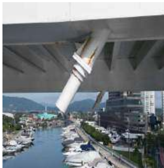
ANCORAGEM MÓVEL E1-MONTANTE P1 IATE NO TUBO FORMA JÁ É NÍTIDA A AÇÃO DA OXIDAÇÃO NO TUBO FORMA. O CAPÔ AINDA PARECE SEM OXIDAÇÃO.
