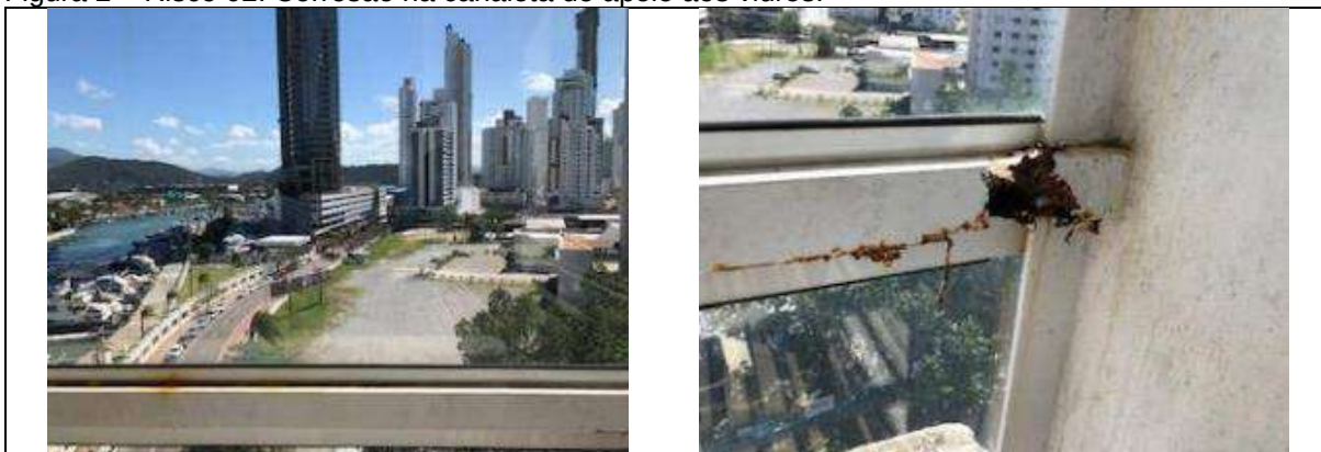
Figura 2 – Risco 02: Corrosão na canaleta de apoio aos vidros.
