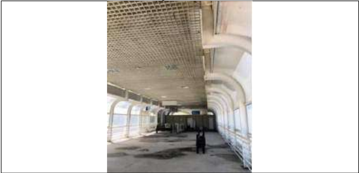
Figura 9 – Risco 10: Placas de teto caindo. Áreas em desuso e fechadas ao público, com abertura nos oitões. Locais com entrada de água.
