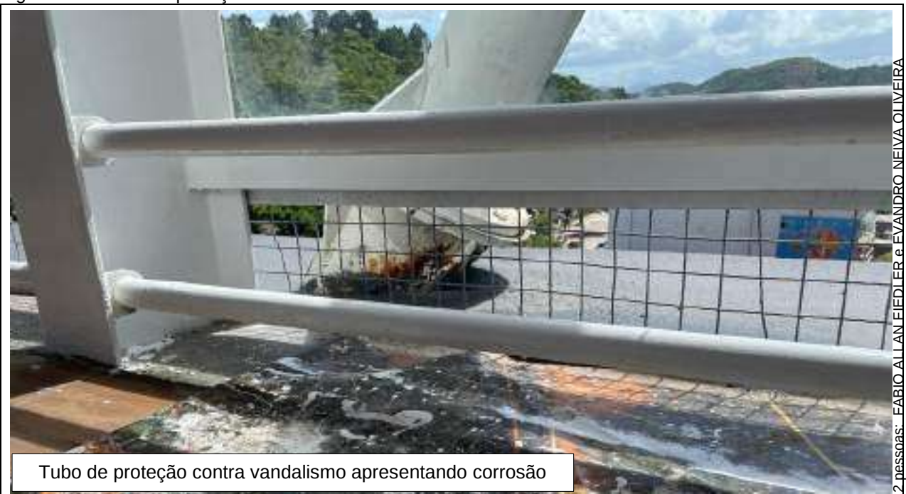
Figura 16 – Tubo de proteção contra vandalismo
