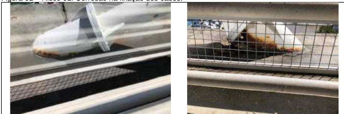
Figura 01 – Risco 01: Corrosão na fixação dos cabos.
